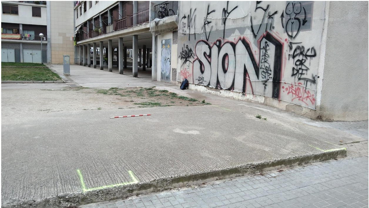
1.- Vista general de l'àrea afectada. Amb la solera de formigó UE 20 en primer pla.
